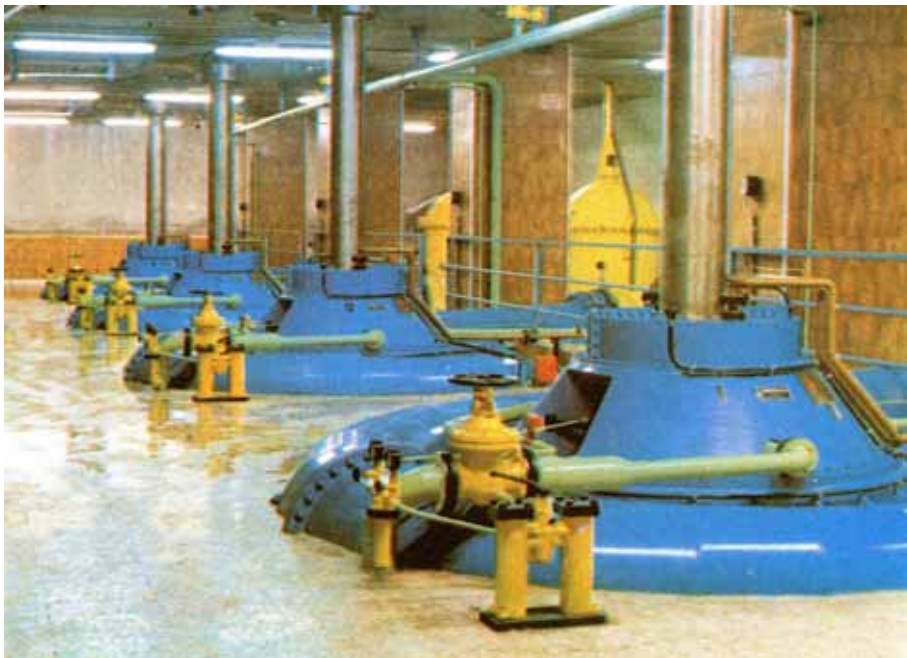
Foto 6. Impulsión de Ojós.
